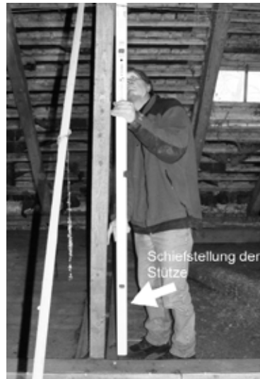
Sorgvoller Blick nach oben. Architekt Reichensperner bei der Untersuchung des Dachstuhls. Deutlich zu erkennen: Die Schiefstellung der Stützen.
