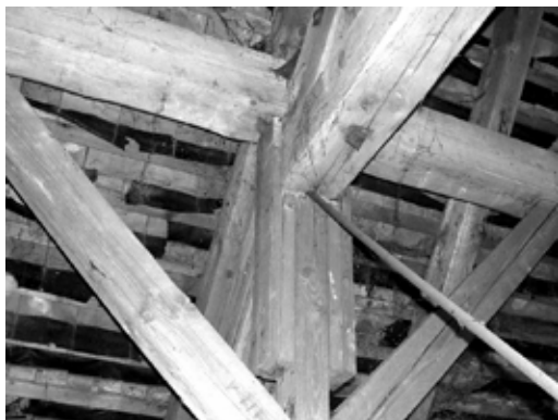
Teil des Dachstuhls der Erlöserkirche. Gut zu erkennen: Die schadhafte Dachpappe.
