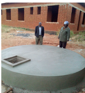
Gästehaus in Gairo mit Wassertank
